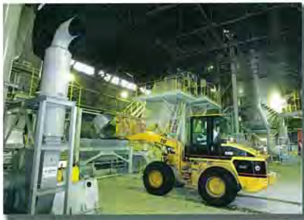
廃プラスチック破碎設備
