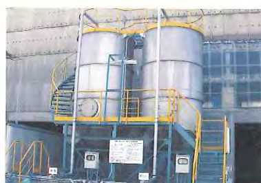
廃液受入設備
