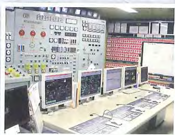
中央操作室 Control room
