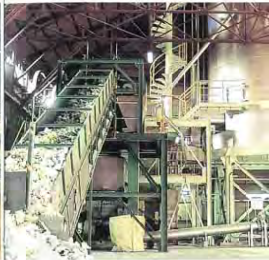
破砕設備に運びこまれた廃プラスチックはセメント製造の燃料として適した大きさにカットされます。
