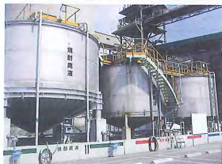
廃酸・廃アルカリタンク
