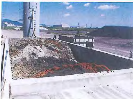
建設汚泥固化設備
