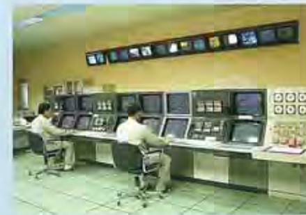
中央制御システム Central control system
