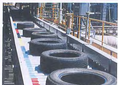
廃タイヤ投入設備
