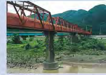
ケーブルベルトコンベヤ Cable Belt Conveyor
