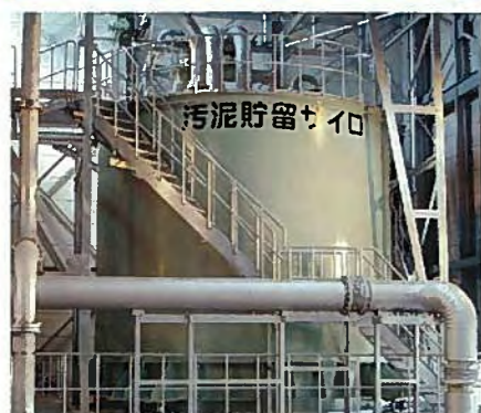
汚泥貯留サイロ
